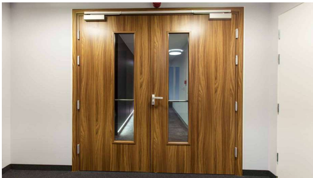
protipožární dveře FR EI30, pevná dřevěná zárubeň
