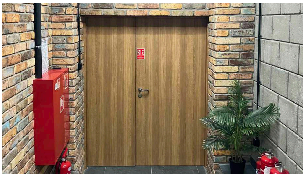
protipožární dveře FR EI30, pevná dřevěná zárubeň
